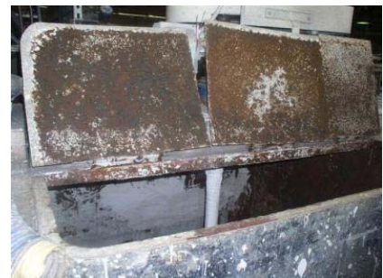
Abertura de un tanque de mezcla de pintura en la que un trabajador murió durante el uso de un removedor de pintura que contenía Cloruro de Metileno.
