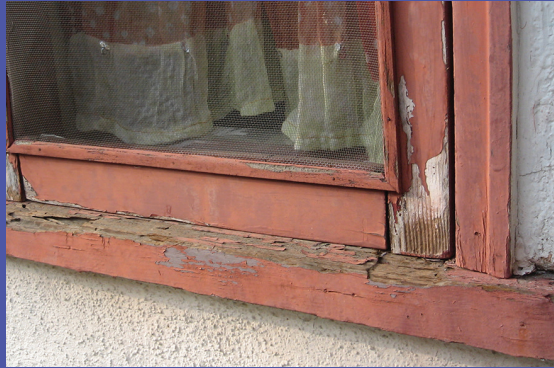
en pintura descarapelada
